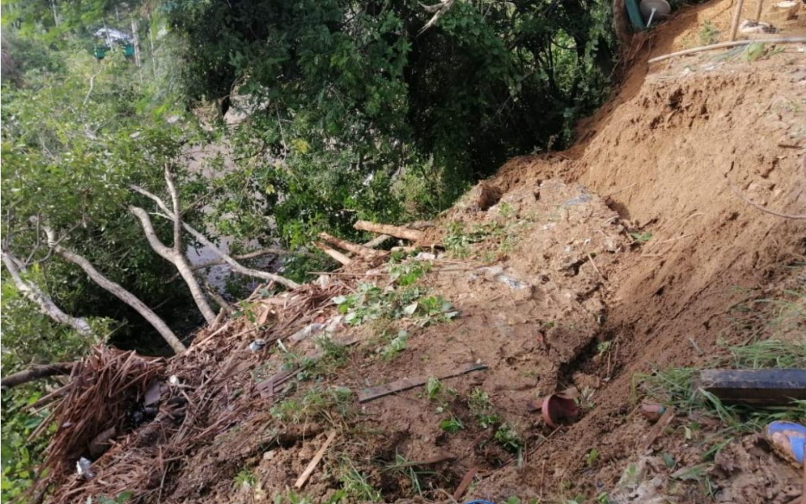
Figura 2.42. Deslizamientos en vía Guaimaral año 2019
