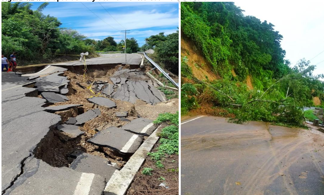
Figura 4.24. Colapso de vía y deslizamientos Guaimaral Tubará
