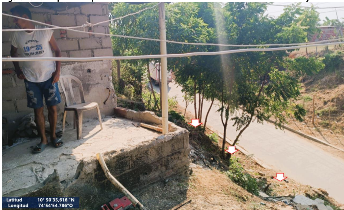
Figura 2.41. Desplome de parte de vivienda Henderson Amaris Cra 15 # 11-120 Barrio bajo
