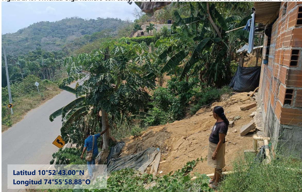
Figura 2.45. Vivienda Olga Romero con colapso de parte del predio en corte de vía Guaimaral – Paluato
