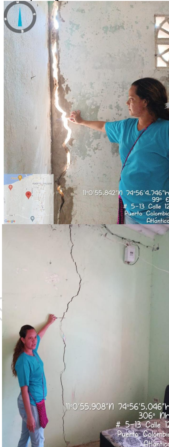
Figura 2.30. Vivienda abandonada por riesgo en Tamarindo Erika Castro
