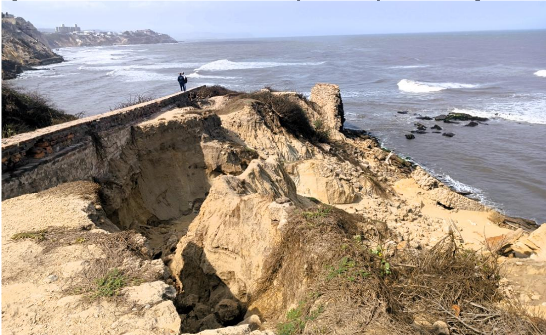
Figura 2.33. Socavación en sector occidental (arriba) y oriental (abajo) Castillo de Salgar
