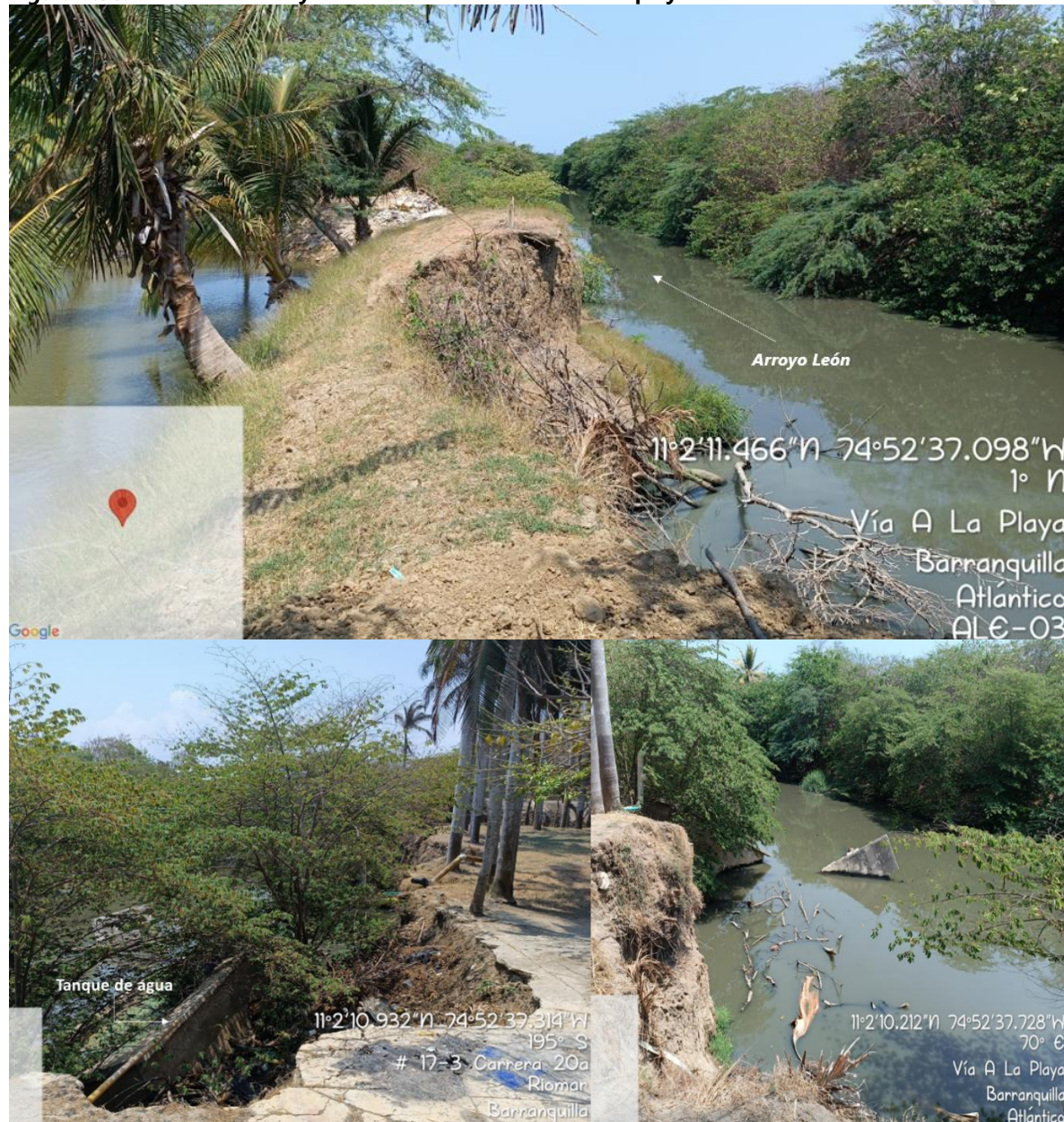
Figura 2.36. Socavación Arroyo León Finca Prisma Nova vía la playa – sabanilla
