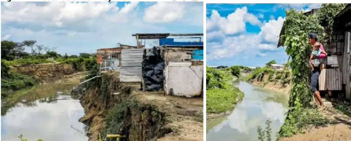
Figura 2.39. Socavación de Arroyo León
