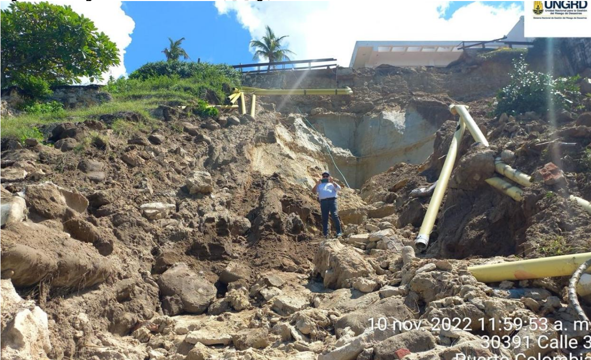
Figura 2.35. Registro de erosión en sector Salgar
