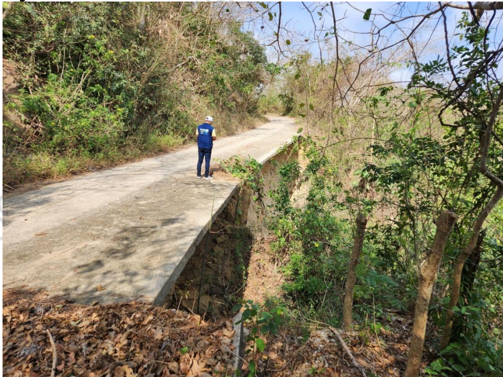
Figura 3.23. Deslizamiento rotacional sobre rocas de la formación Hibácharo, que afecta la vía Sibarco – Pital de Megua.
