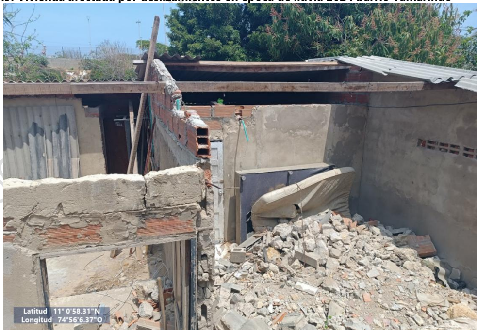
Figura 1.3. Vivienda afectada por deslizamientos en época de lluvia 2024 barrio Tamarindo
