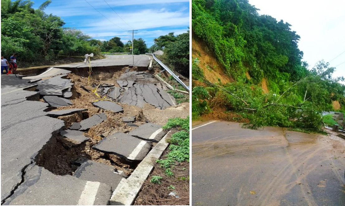
Figura 2.43. Colapso de vía y deslizamientos Guaimaral Tubará
