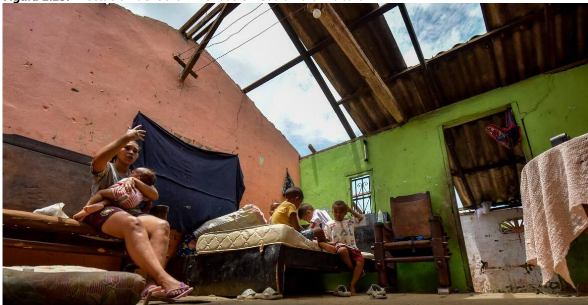
Figura 2.25. Afectación del 90% viviendas en Guaiamaral Tubará
